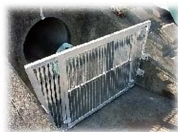
排水路くずカゴ
